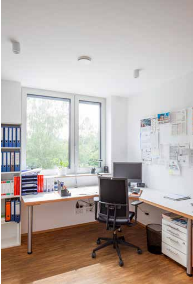
Mit unterschiedlich großen Deckenmodulen konnte die Zehnder Heiz- und Kühldecke mit Gipskartonverkleidung flexibel an die Räume im neuen Bürogebäude der Jäger Haustechnik angepasst werden.
